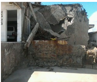
Figuras 13: Residências destruídas pela ação do mar. Foto: Tiradas pela autora (Jan. 2015/ Dez. 2015)
