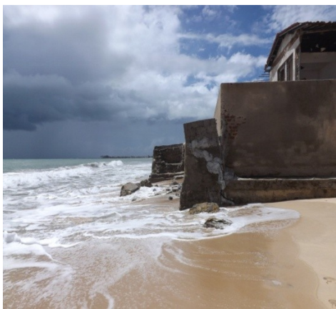
Figura 22: Ação destrutiva do mar na praia do Forte. Foto: Tirada pela autora, 2017
