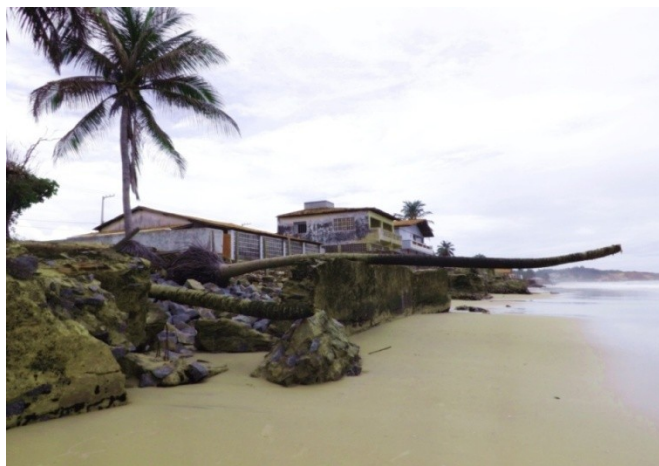
Figura 40: Entulhos de construções na costa.
