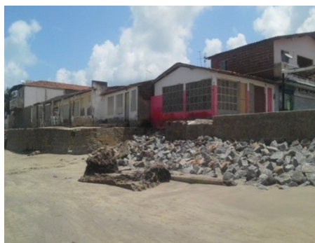
Figuras 14: Residências destruídas pela ação do mar. Foto: Tiradas pela autora (Jan. 2015/ Dez. 2015)
